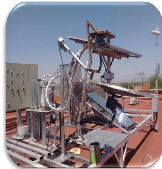
Plataforma solar ITESCA
