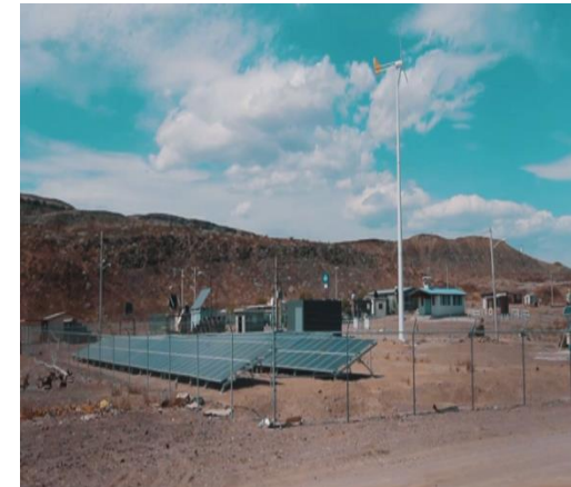
Planta de Autoabastecimiento de Puertecitos Baja California. (fuente: www.energiabc.gov.mx )
